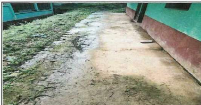
Foto 4: Se observa la necesidad de la reparacion de torta de concreto.
