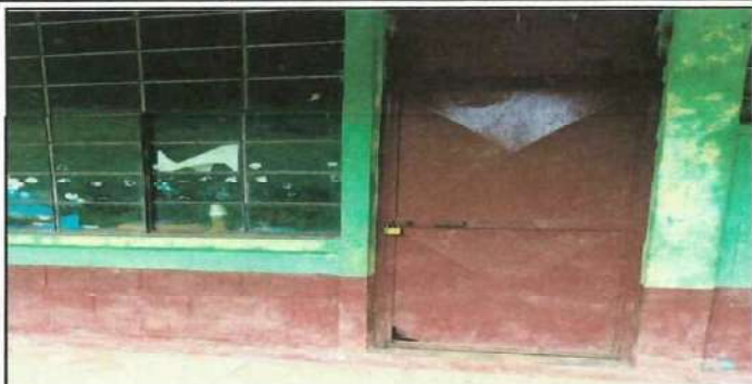
Foto 1: Se observa la necesidad de la sustitucion de puerta de metal con chapa para mayor seguridad del establecimiento.
